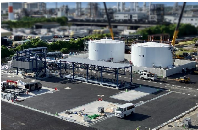
原料（廃食用油）の受け入れ設備
