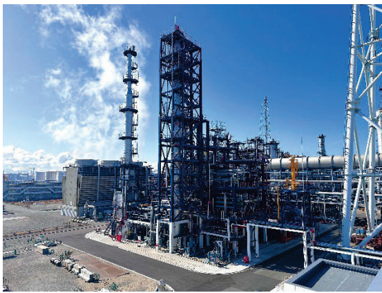
完工した SAF 製造装置
