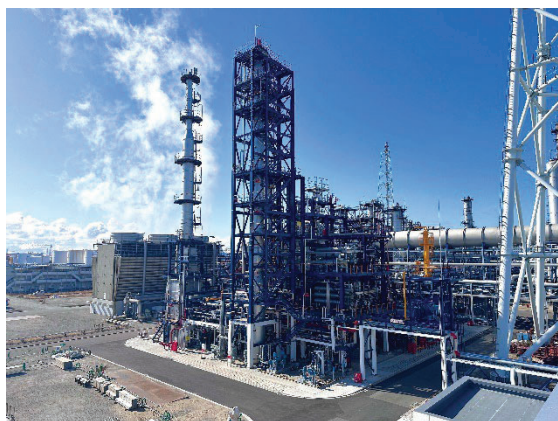
完工した SAF 製造装置
